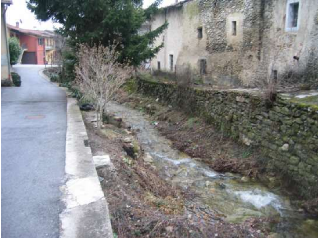
F.05 - Rio Faussimagna: all'ingresso dell'abitato di Villar San Costanzo (verso valle).
